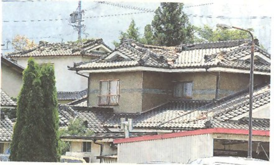
屋根瓦が崩れた民家があちこちで見られた―30日午前10時50分、松本市寿豊丘
