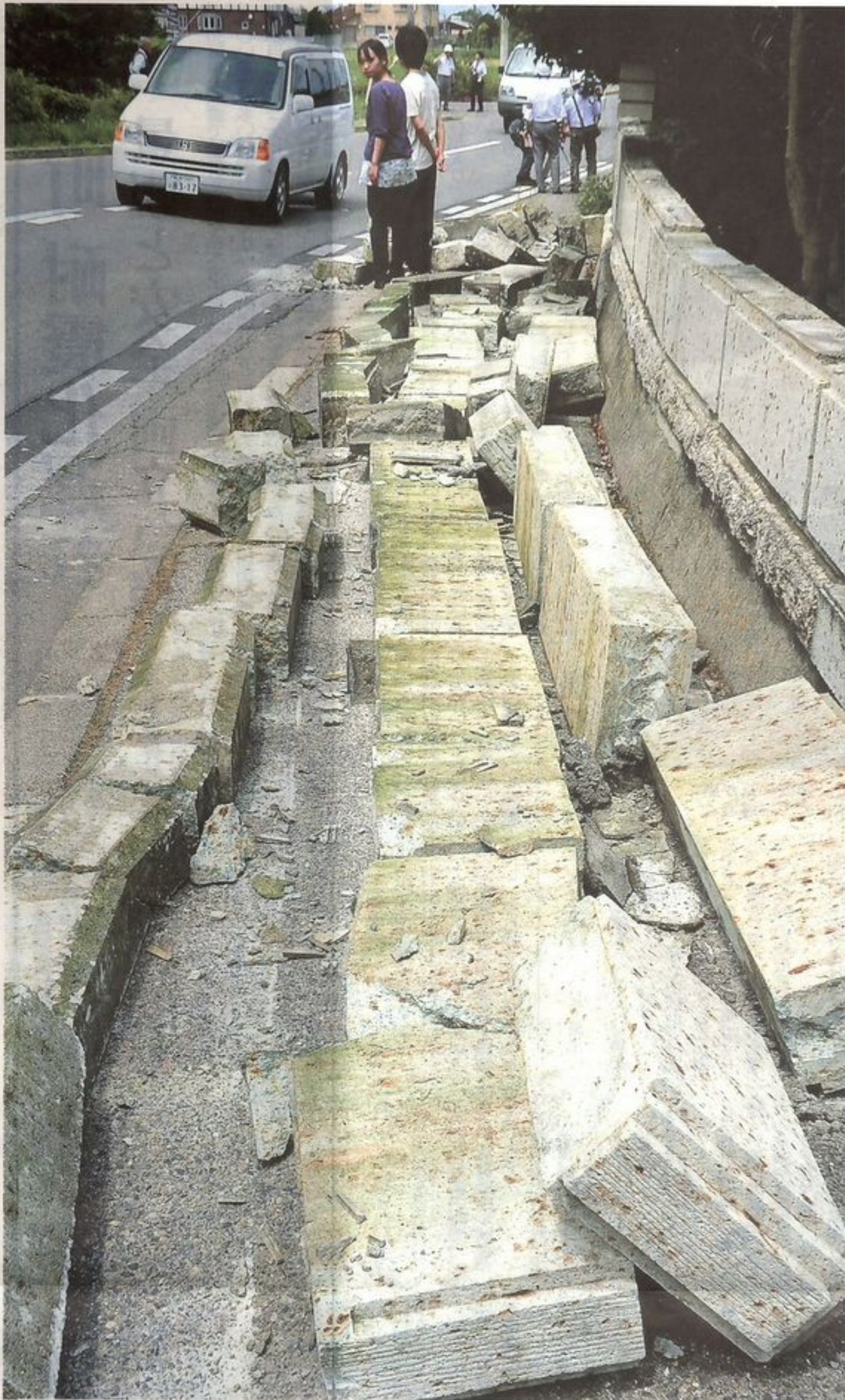
倒壊 ブロックの列
