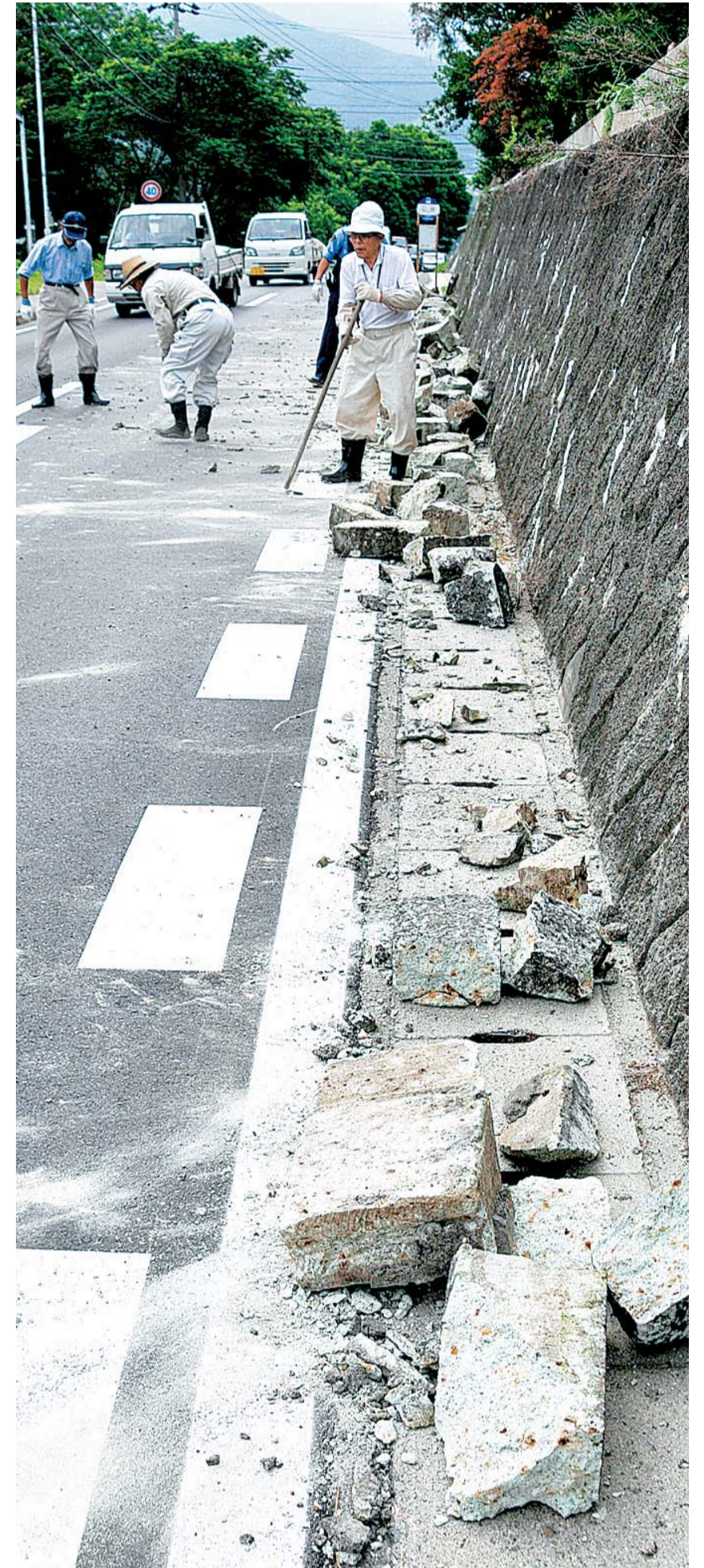
揺れの影響で道路沿いの石塀が崩れ落ちた(30日午前8時35分、松本市中山下和泉)
