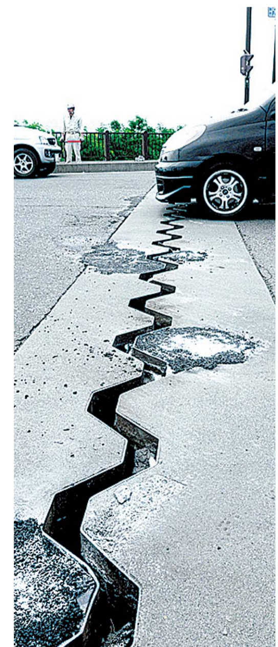
橋げたがずれ、道路との接続部分が広がった(二子橋30日午前10時10分ころ)
